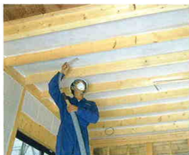
⑦階床防音 2階床より100mm下に横木を取り付け、デコスシートを弛みのないように張り、フローリングします。公共建築にも採用されています。
