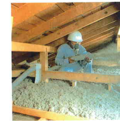
⑥天井断熱 施工密度 25±3kg/m 3 間仕切り壁の上部の通気を止め、セルロースファイバーを専用施工機からブローで風送。雪を積もらせるように吹き込む。
